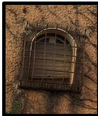
Figure 76 l'état de la menuiserie de la villa (source : auteur)
