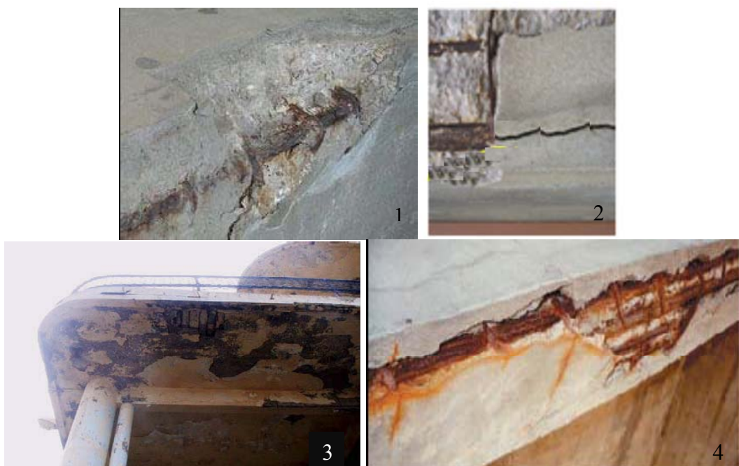
Figure 1. 14 Exemples de corrosion par carbonatation et d'éclatement de béton d'enrobage [(1) et (2) source http://fr.wikipedia.org/wiki/Fichier:Betonrot_Hippodroom.JPG , (3) et (4) Dak, 2009]
