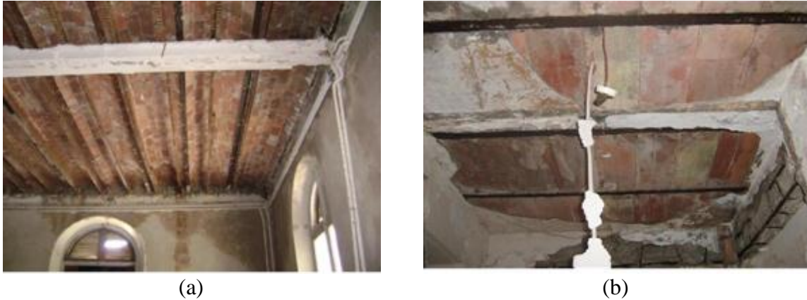
Figure 1.28: Désordres dans les planchers à ossature métallique
