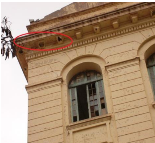
Figure 3.4 : Dégradation des éléments décoratifs de plâtre
