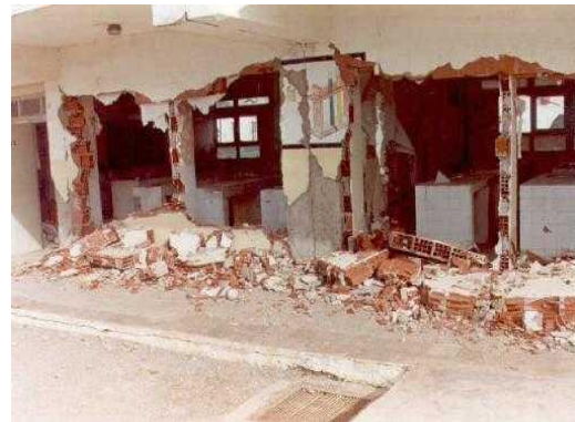
Figure 1.8: Une école détruite par le séisme
