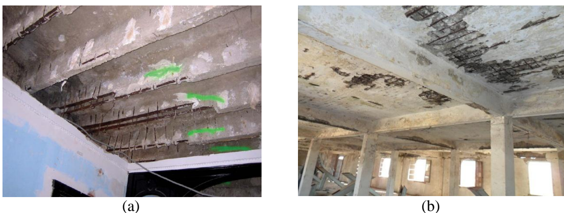
Figure 1.29: Désordres dans les planchers en béton armé
