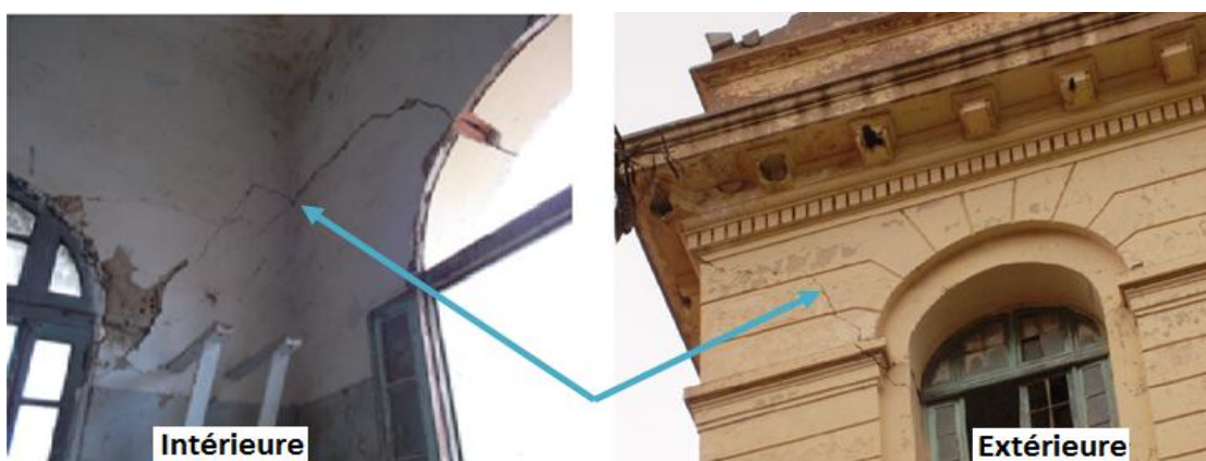
Figure 3.1 : Fissures profond (le dernier étage)
