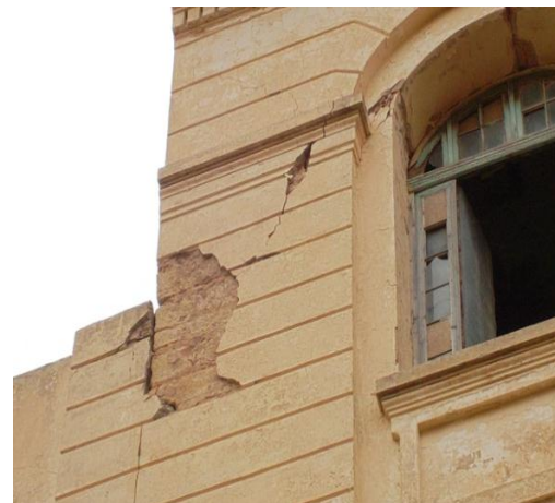
Figure 3.5 : Décollement par plaques des enduits des enduits
