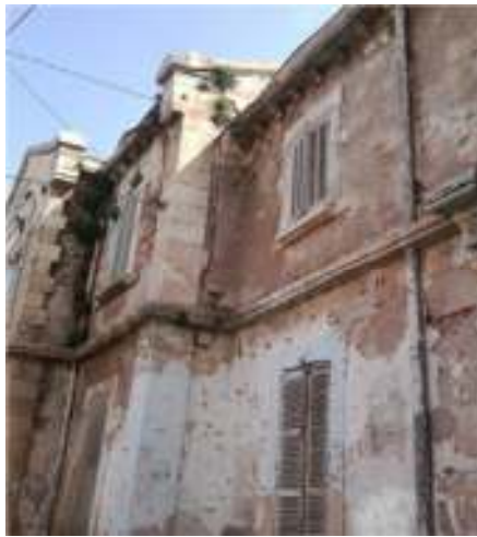
a-dégradation de crépi extérieur
