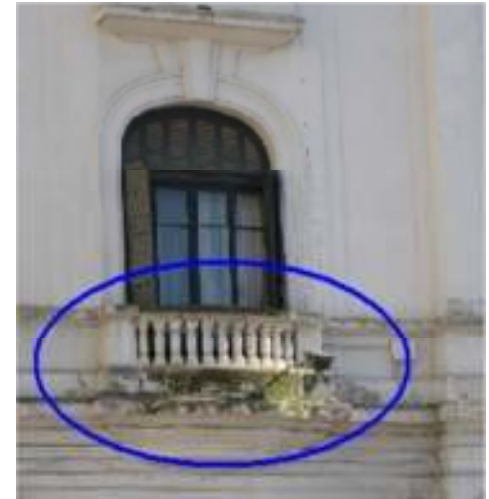
d- désordre sur le balcon
