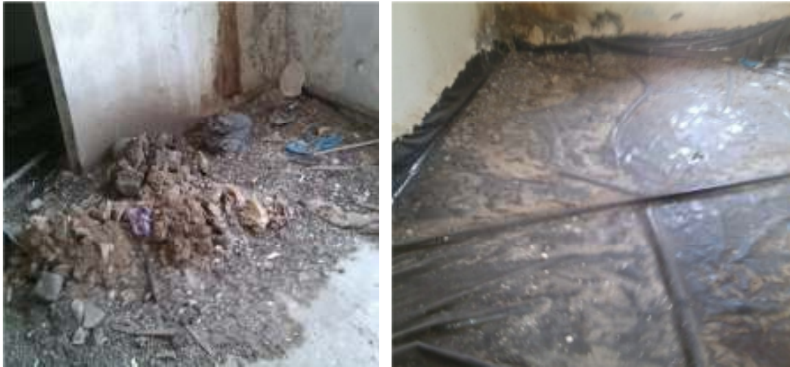
a- Déchets accumulés sur la dalle
