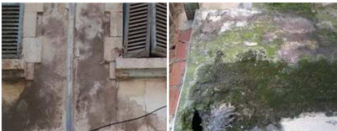
a- Destruction de la structure de la pierre sous l'influence du sel et de l'humidité
