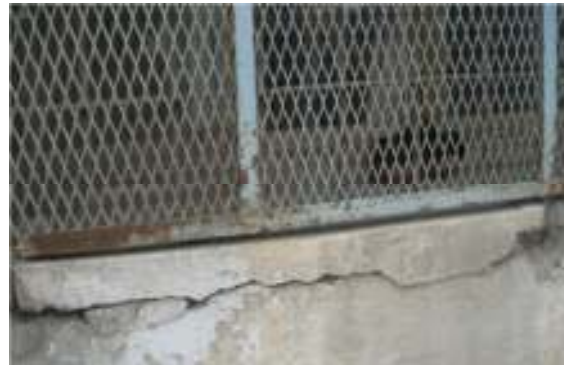
b- fissure en dessous d'une fenetre
