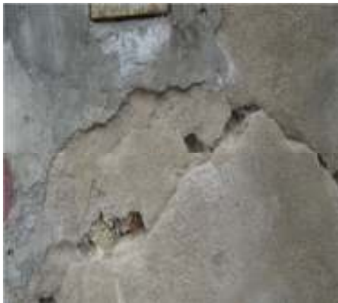
c- fissure marquée à l'exterieur
