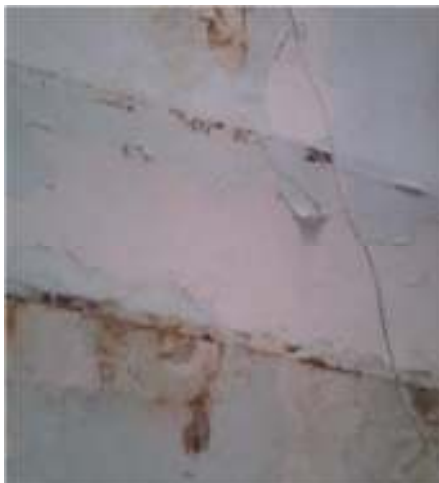
a-Oxydation de profilés métallique.
