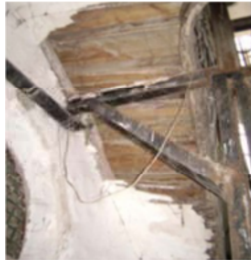
b-Zone des installations dégradée
