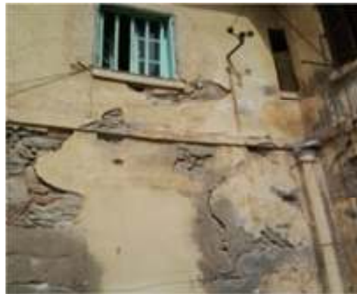
d- des fissures en lézards
