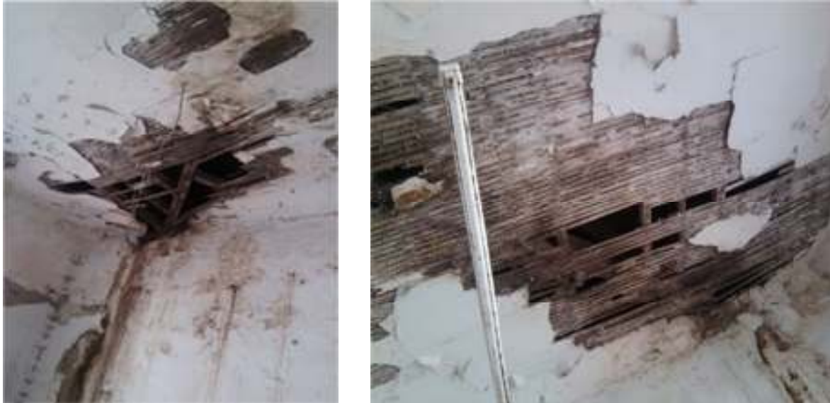
Photos3.4 : Dégradation d'étanchéité liée à l'infiltration de l'eau
