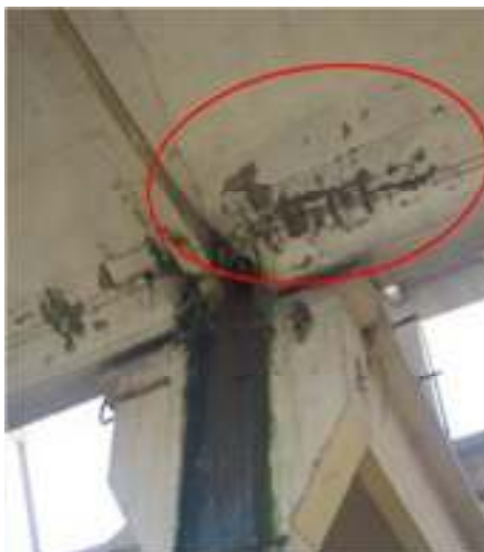
c- corrosion des aciers
