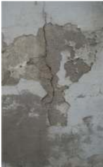
a- fissure marquée entre les blocs
