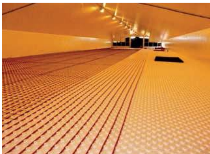
Figure 5.20 Mise en place d'un réseau de tuyauteries dans un sol bétonné [ITAVI, 2014]
