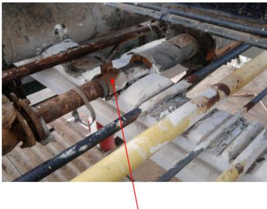
Figure III.3 : Utilisation d'un collier pour l'élimination d'une fuite dans une ligne de gaz (éthane) [41].
