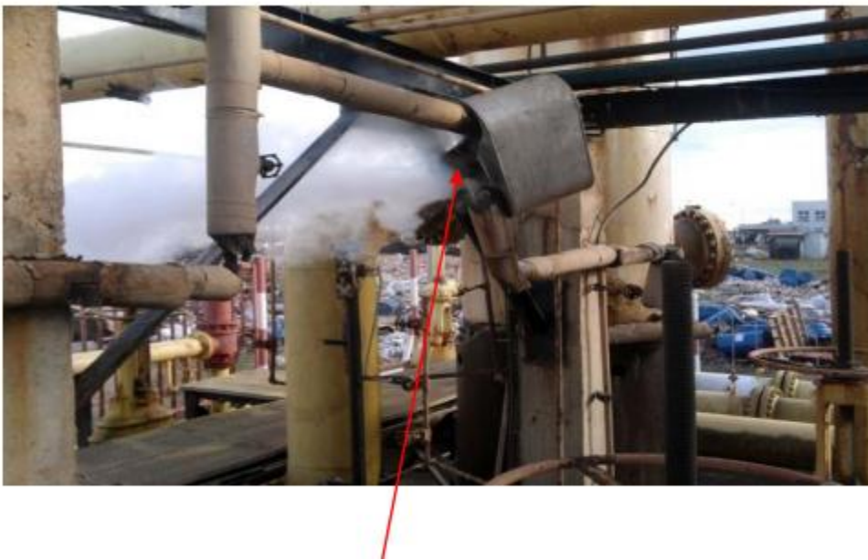
Figure. III.5 : Fuite de vapeur importante pouvant corroder des équipements avoisinants et être à l'origine d'un incident voire accident [41].
