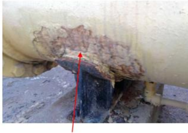
Figure III.6 : Corrosion avancée sur les supports de ligne de gaz [41].
