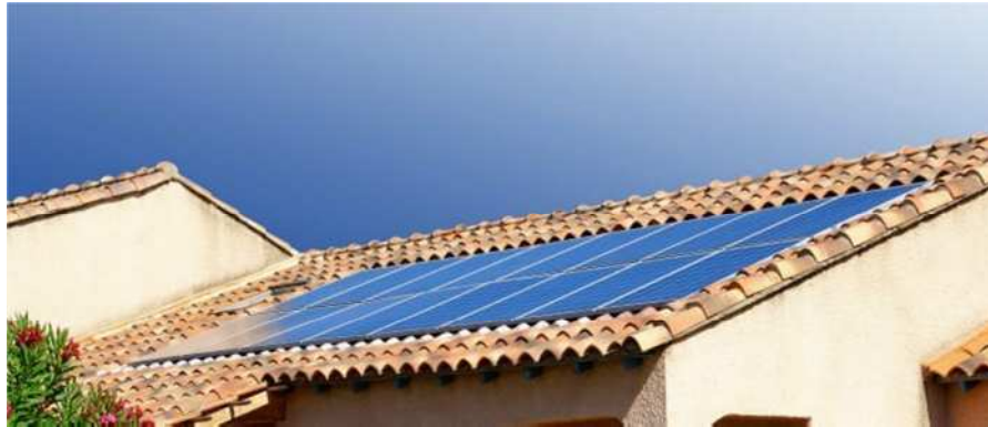
Figure II.12 : exemple d'un panneau sur le toit d'un habitat
