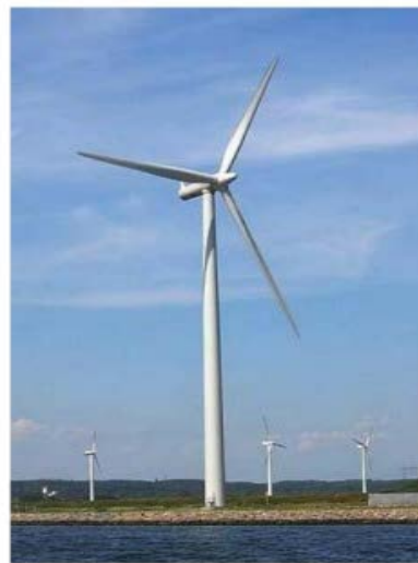
Figure I.4 : Eolienne à axe horizontal [1]
