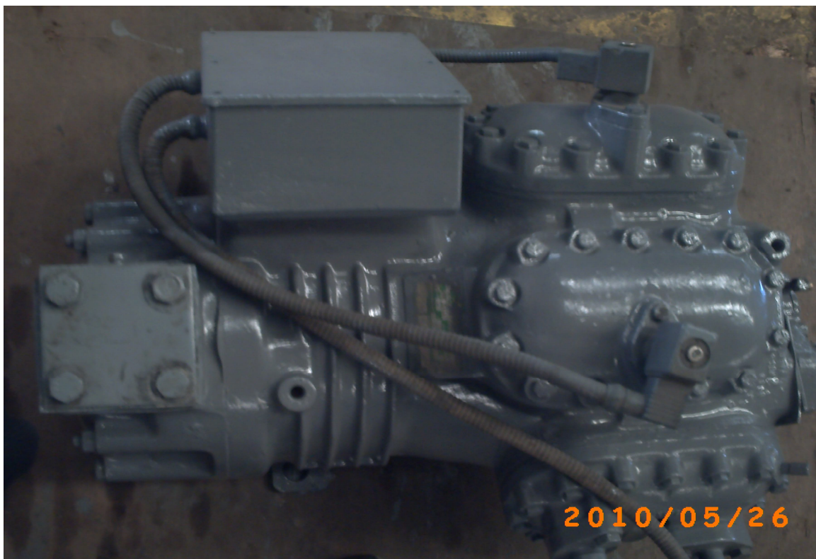
Figure (I.3): Le compresseur de l'installation.
