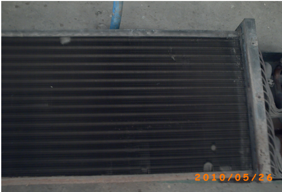
Figure (I.4): Le condenseur de l'installation.
