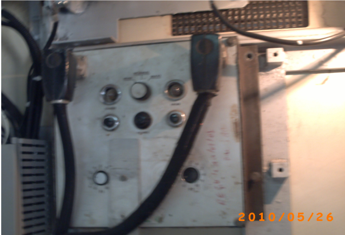
Figure (I.7): Armoire de défaut de fonctionnement.
