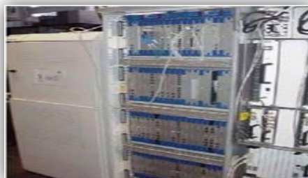
Figure II. 7: Contrôleur de Réseau Radio (RNC)
