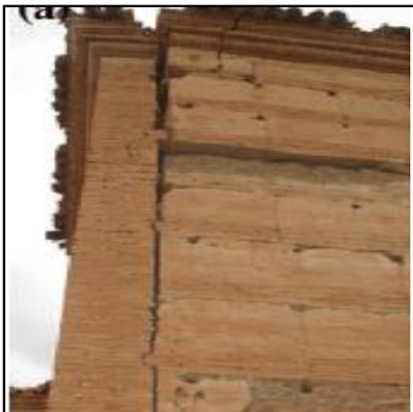
Fig. 76: Tassement dans un mur en pisé.
