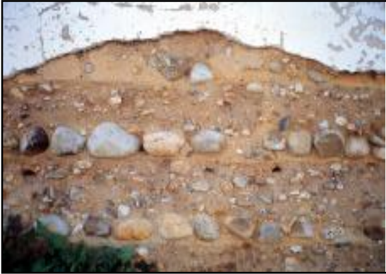
Fig. 69: Les lignes de banchages sont souvent marquées par les lits de chaux ou de pierre intercalés (Portugal).
