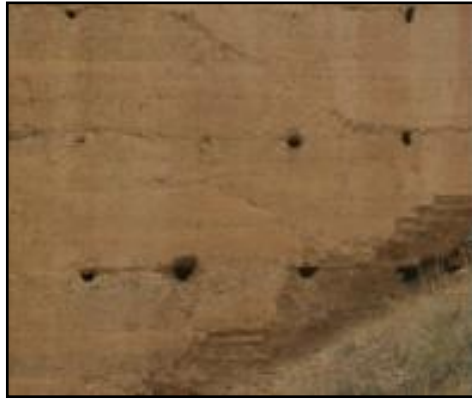
Fig. 75: Erosion en bas de mur en pisé.
