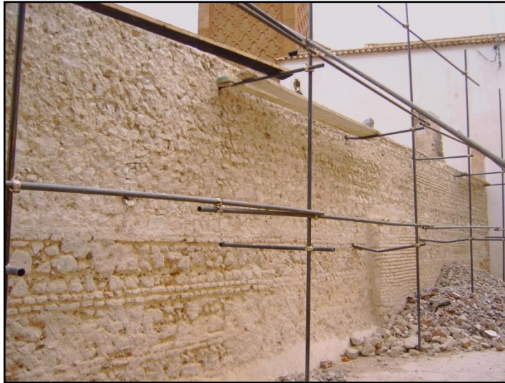
Fig. 139: Décapage des enduits. Source: BET ATTAR.
