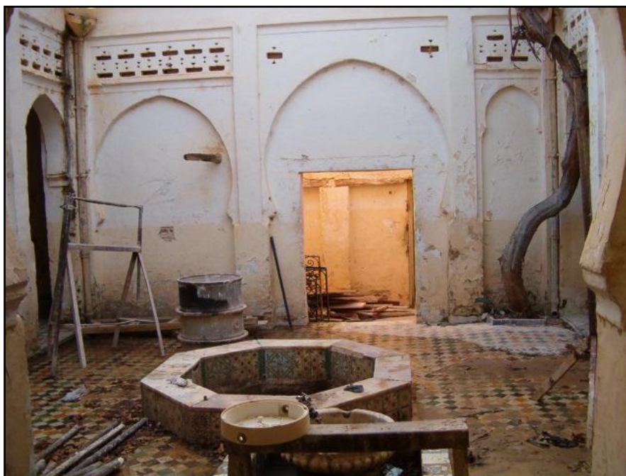
Fig. 137: Vue de la maison avant les travaux de restauration. Source : BET ATTAR.
