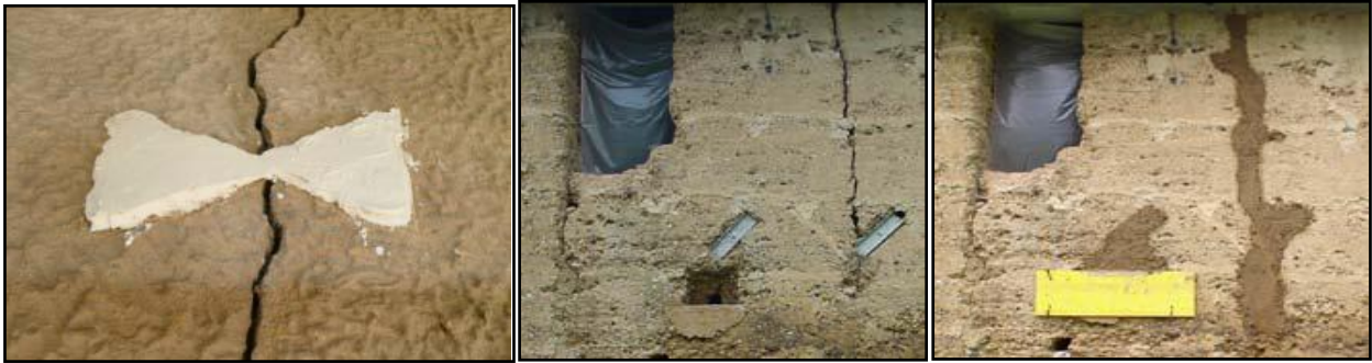
Fig. 79: Témoin en plâtre sur une fissure.
