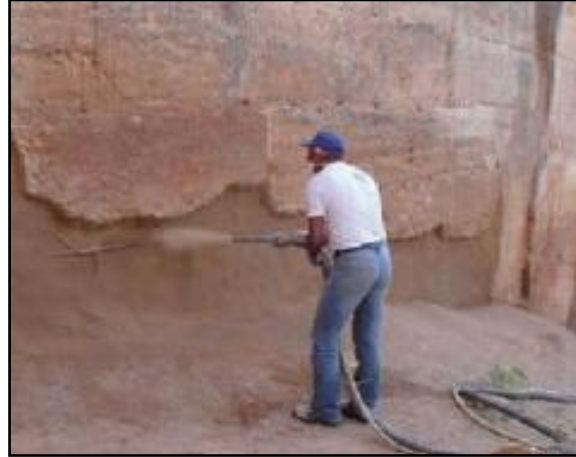
Fig. 82: Réparation de l'érosion basale du château de Paderne.
