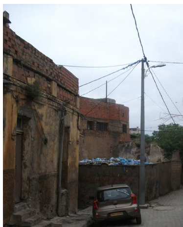
Photo n°42 : dégradation des façades urbaines
