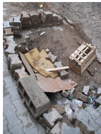
Photo n°44 : dégradation du réseau d'assainissement
