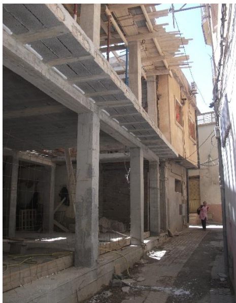
Photo n°41 : le non-respect de l'identité architecturale. (Source auteur, 2015)
