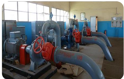
Fig248. Alimentation en eau
