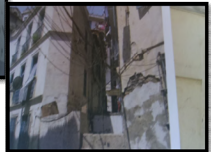
Figure 57. Des câbles électriques anarchiques et vétustes.
