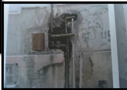
Figure 56. Les fuites des canalisations.
