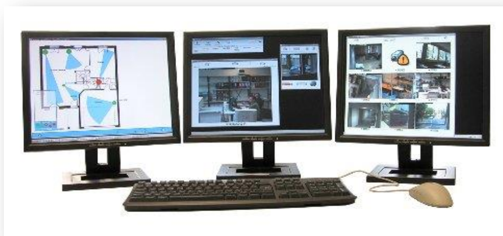
Figure 69 : moniteurs de surveillance
