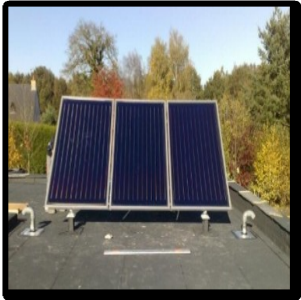
Figure 131. Chauffe eau solaire. 115
