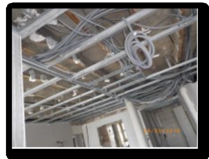
Figure 111. Passage des câbles et gaines techniques. 101
