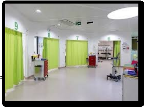
Figure 110. Faux plafond dans un hôpital.
