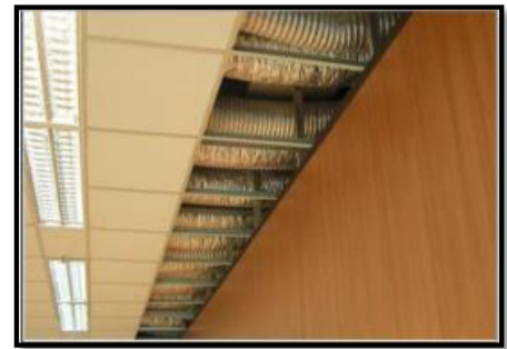
Figure 7 : passage des gaines
