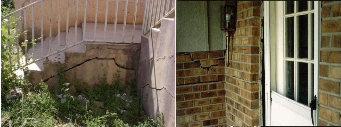
Figure 1.16. Les fissurations causés par le gonflant.
