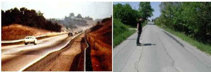
Figure 1.17. Le gonflement affecte la route.
