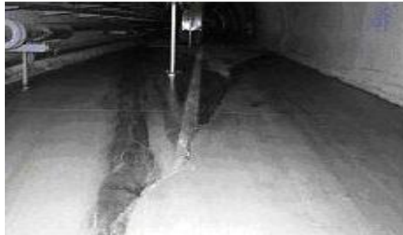
Figure 1.18. Soulèvement puis dislocation du radier d'un tunnel, (WAKIM, 2005).
