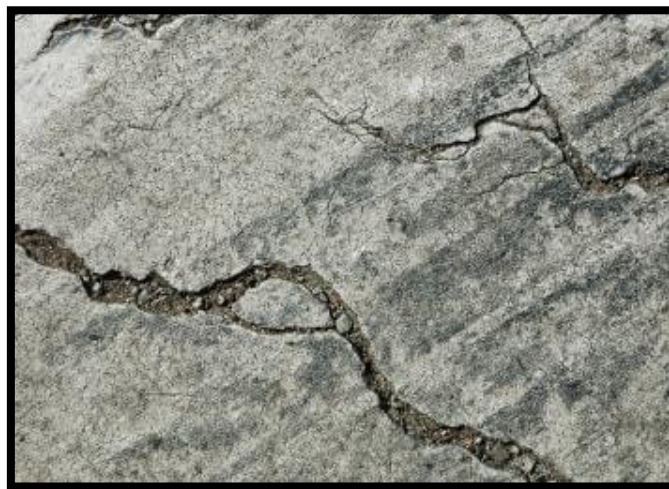
Figure 70 : phénomène de fissuration du béton 89
