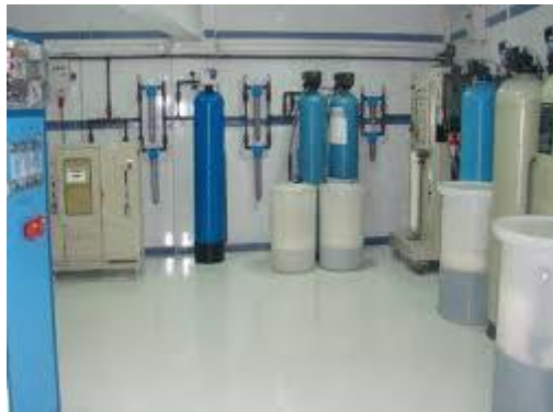
Figure n°06 : Station de traitement d'eau pour hémodialyse
