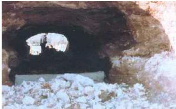
Figure 3.7 : Renard dans un barrage (Lautrin, 2002)
