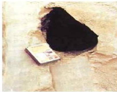
Figure 3.3 : Phénomène de déboufrage au barrage de Lafage (Lautrin, 2002)
