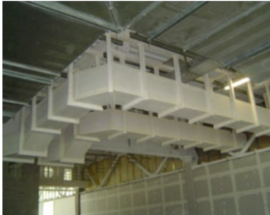
Figure 181: conduit de désenfumage
