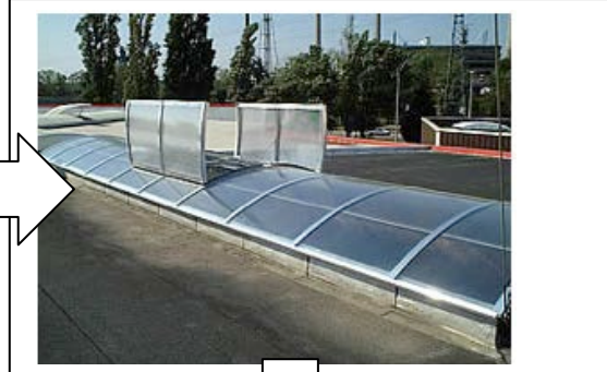
Figure184: gaine de désenfumage
