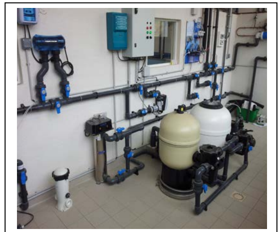
Figure 114: pompe d'alimentation de l'eau
