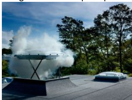
Figure 183: gaine de désenfumage
