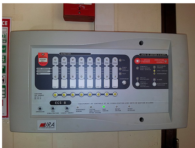
Figure 170: équipement de contrôle et de signalisation
