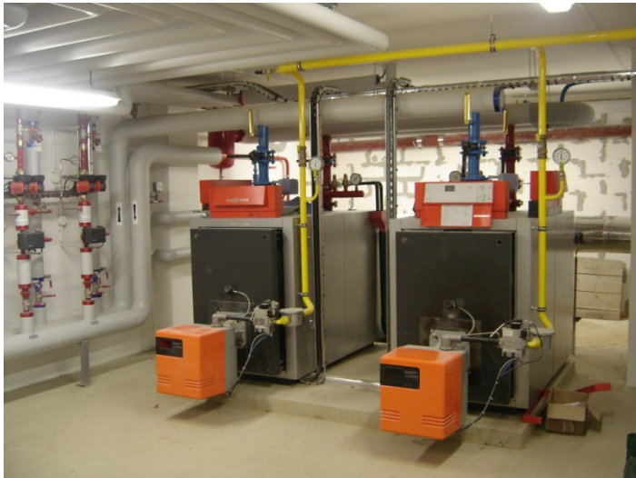
Figure 117: unité de chaufferie dans le local technique
