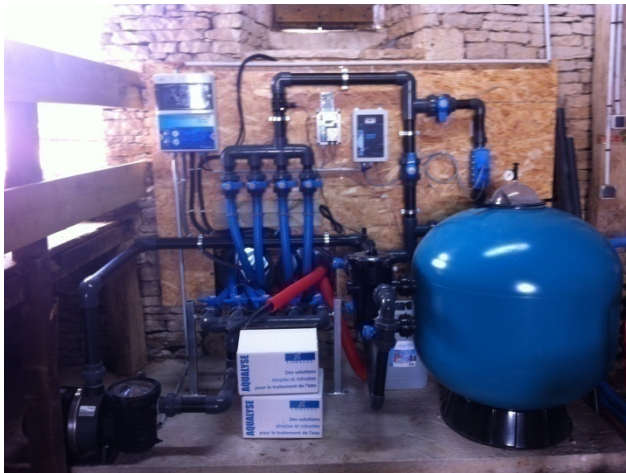
Figure113: pompe de filtrage d'eau dans le local technique d'épuration
