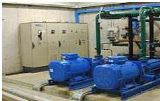
Figure 156: compresseur d'air et station de pompage de l'eau
