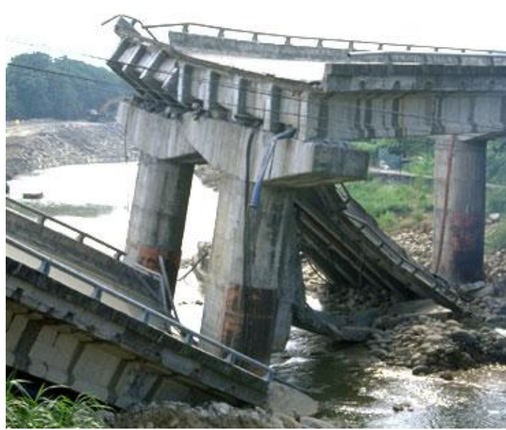
Figure 1.3 : Effondrement du tablier d'un pont à poutres préfabriquées lors du tremblement de terre de Taiwan en 1999 [2].
