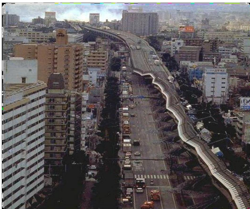
Figure 1.6 .b Rupture des piles par cisaillement. KobéJapan 1995. [4]
