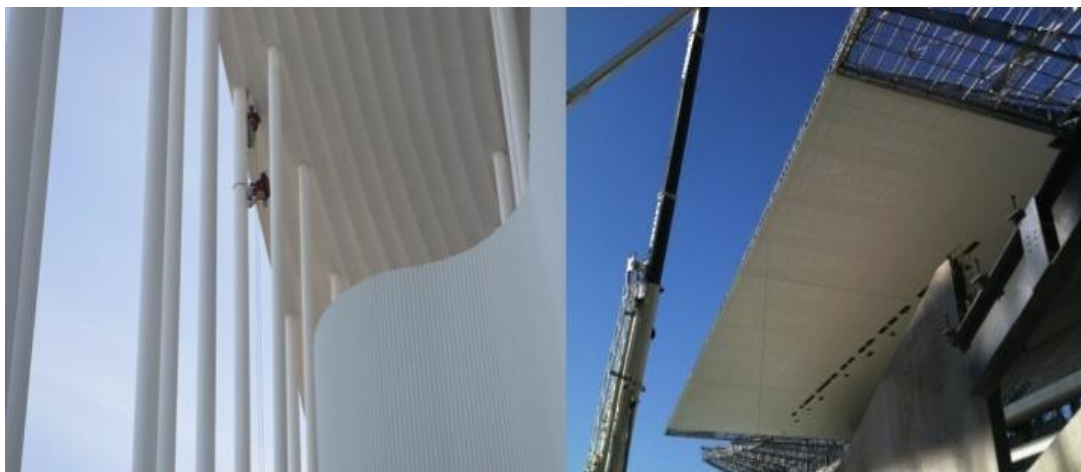
Figure 31 : L'utilisation de la laine de roche dans la toiture du nouvel stade de bordeaux
