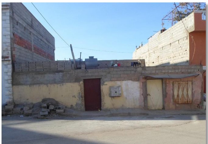
Figure : construction en mauvaise état
