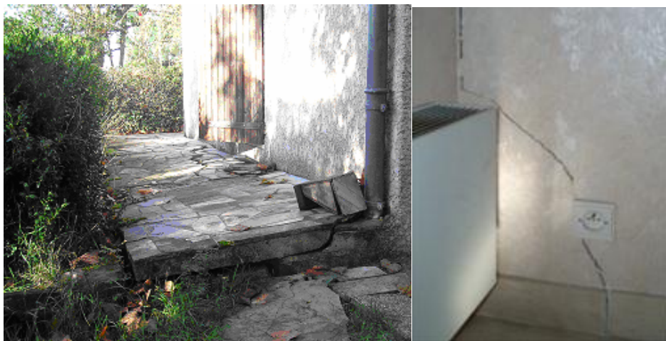
Figure 2.4 : Désordres de la structure au cours des périodes de sécheresse (Nowamooz, 2008).
