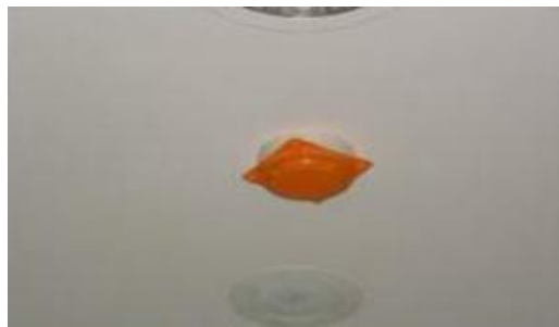
Photo 42 : L'éclairage de signalisation des issues de secours
