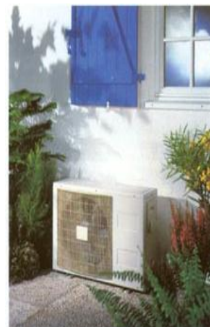
Photo43 : la partie extérieure de Split système
