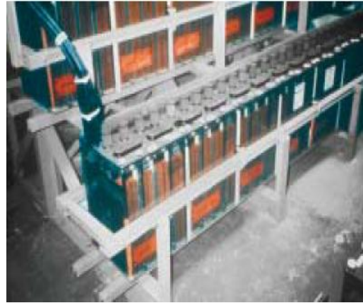
Photo 50 : Bien fixés, les groupes de batteries et les groupes électrogènes de secours sont capables de fournir de l'électricité même après un séisme de forte intensité.
