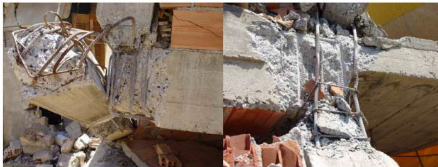
Figure 11 : Effondrement à cause de l'absence d'armatures transversales dans le nœud et dans la zone critique du poteau
