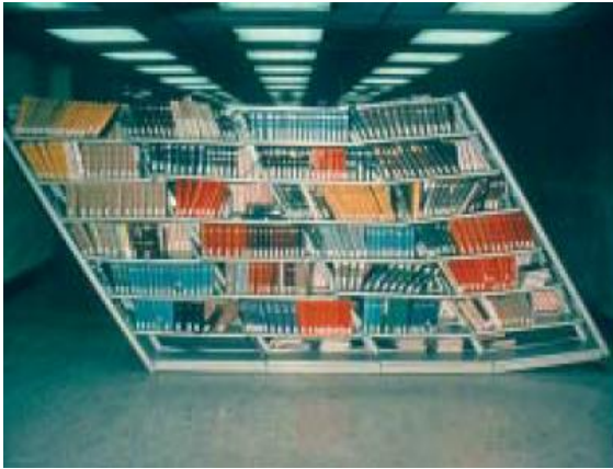
Photo 49: Les livres représentent une telle masse qu'il faut ancrer solidement les étagères et les contreventer dans les deux directions
