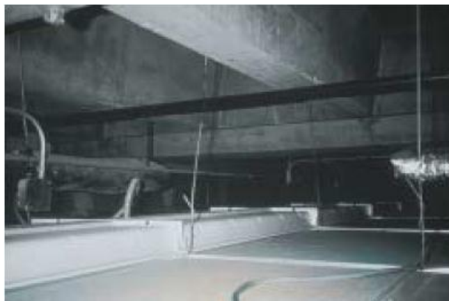
Photo 45 : les faux plafonds bien fixés
