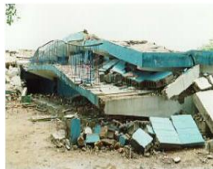
Photo18 : Séisme de Cariaco, 1997, Effondrement en « mille-feuilles » des planchers d'une construction/ source : Document EERI
