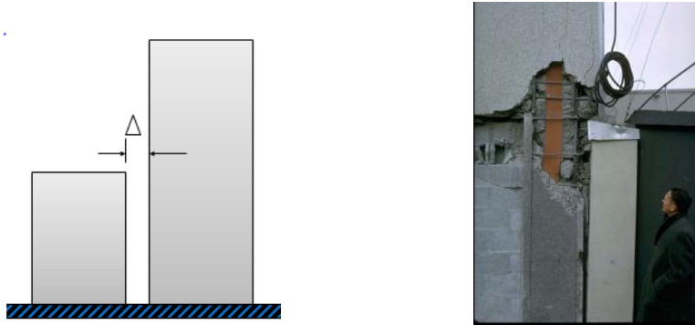
Figure 15 : Entrechoquement de bâtiments voisins séparés par un joint de dilatation. Un joint de dilatation est insuffisamment dimensionné pour que les déformations de chaque structure puissent se faire sans interaction.
