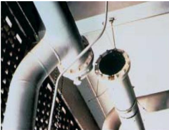
Photo 47 : Les conduites – notamment celles de gros diamètre comme c'est le cas ici – sont très vulnérables si elles ne sont pas fixées solidement
