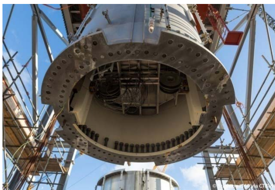
Figure n 223 : le contrepoids à l'intérieur de tube
