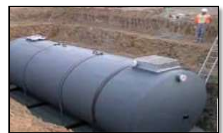
Photos 10 : Cuve de récupération des eaux
