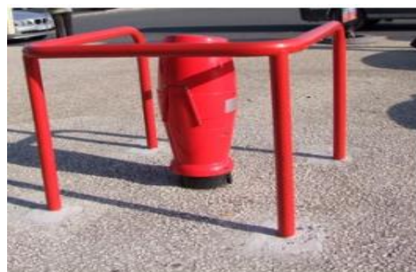
Etriers pour protection des bornes d'incendies
