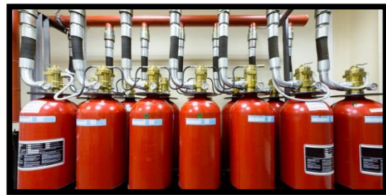
photo 42 : réservoirs de gaz
