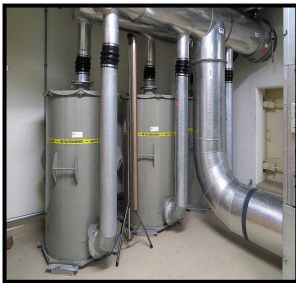
Photo 48 : Filtration d'air dans un bunker en Suisse
