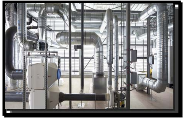
Fig.1.7 - représente les locaux techniques
