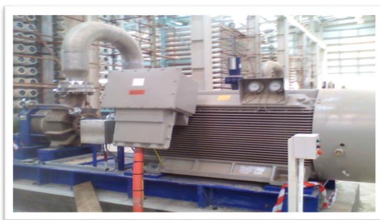
Figure n°16 : Pompe à haute pression (65 bars).
